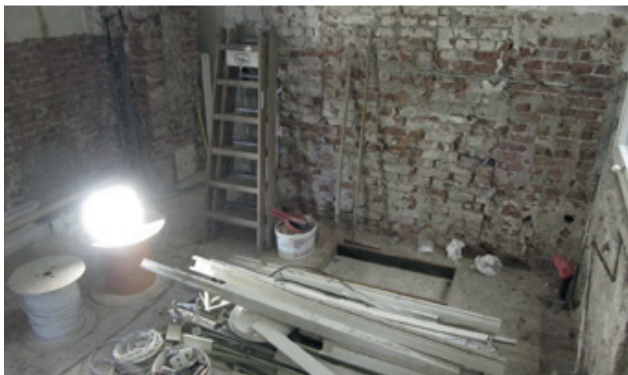
Die Mauer war nicht viel mehr als eine Haltevorrichtung für die Fliesen und bestand lediglich aus aufeinandergesetzten Steinen mit einem Hauch Zement.
